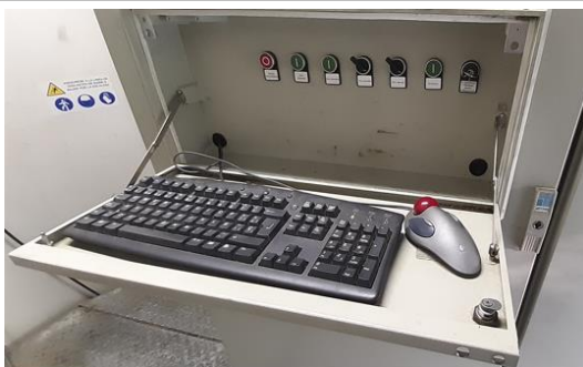
Mejora tecnológica implantada. Retrofit done on site.
