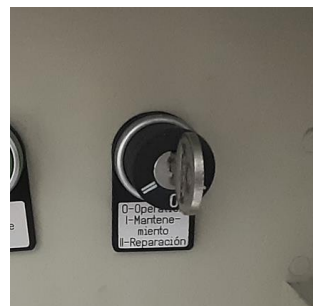
Selector en condiciones de operación. Operation mode in the selector.
